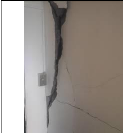
圖 7. 受災後之牆面(此為儀器室之牆壁)
